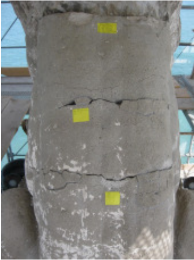
Abb. 33: Auffallend horizontale Rissbilder deuten auf den Herstellungsvorgang hin.
