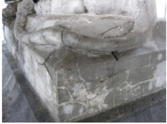
Abb. 9: Vorzustand, nach der Reinigung. Der ganze Eckbereich ist stark zerrissen.
