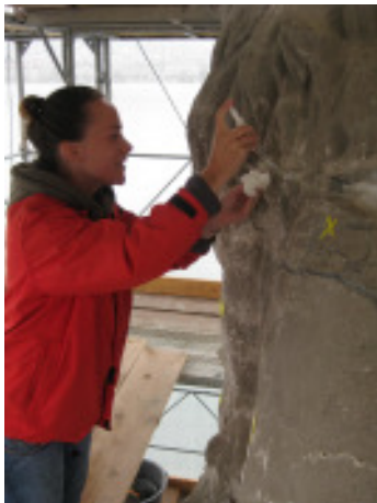
Abb. 42: Corina Ruthishauser, Vergolderin und Studentin Master of Arts in Restoration HKB, beim Injizieren von Rissen
