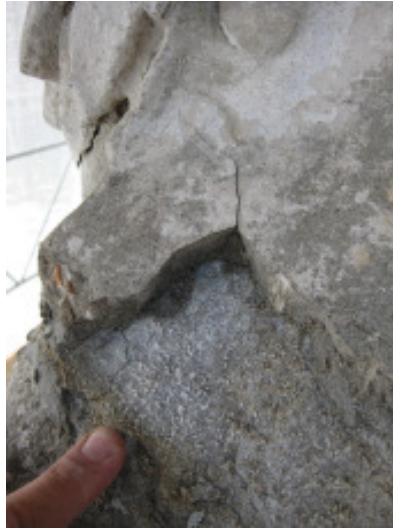
Abb. 34: Schnell ausblühende Ettringit-Salzkristalle fördern die Entstehung der Ablösungen.
