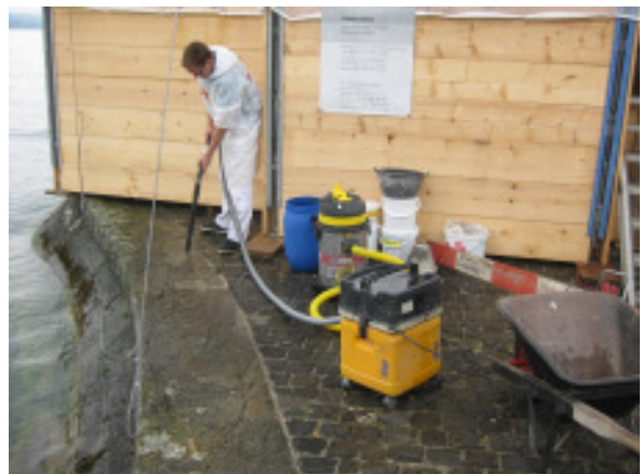
Abb. 23: Beim Überlauf in den See (tiefster Punkt) wurde mit zwei Nasssaugern Wasser und Schmutz aufgefangen und in Fässer (blau) abgefüllt. Beim Parkplatz wurden diese in einen Gulli geleert und so der Kanalisation zugeführt.
