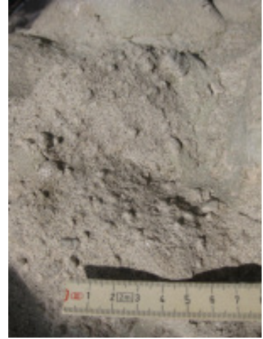
Abb. 16: Ausgewaschene Konturen und merkwürdige, mehrere Millimeter reliefierte Pusteln bei den direkt bewitterten Oberflächen des Zementsteins. Hier auf dem Kopf.
