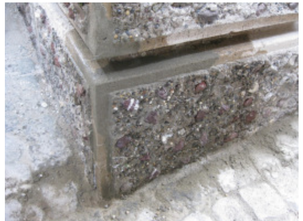
Abb. 37: Fehlstellen wurden mit mineralischem Zementmörtel und Kieselsteinen imitiert.
