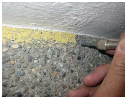
11 Kontrolliertes Abschälen von blätternden Farbschichten mit einem feinen, gut zu führenden Presslufthammer und einem geschärften Breitmeißel.
